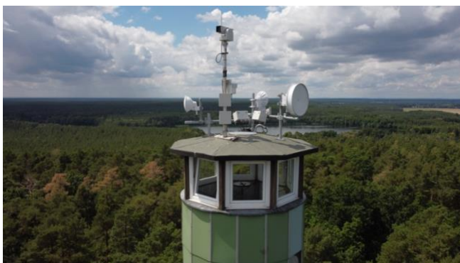
IQ FireWatch installiert auf Feuerwachturm in Zesch am See, Brandenburg
